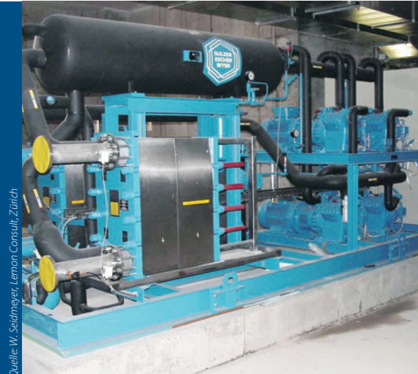
Abb. 6 Als Wärmepumpe in der Anlage DFS kommt ein Aggregat von Axima zum Einsatz, links: Verflüssiger und Verdampfer, rechts: die vier Kompressoren mit elektrischen Antriebsmotoren
