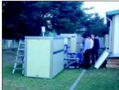
Abb. 8: Versuchs-Wärmepumpe von HP System Tech mit Warmwasserspeicher und Eisspeicher (Oktober 2003)
